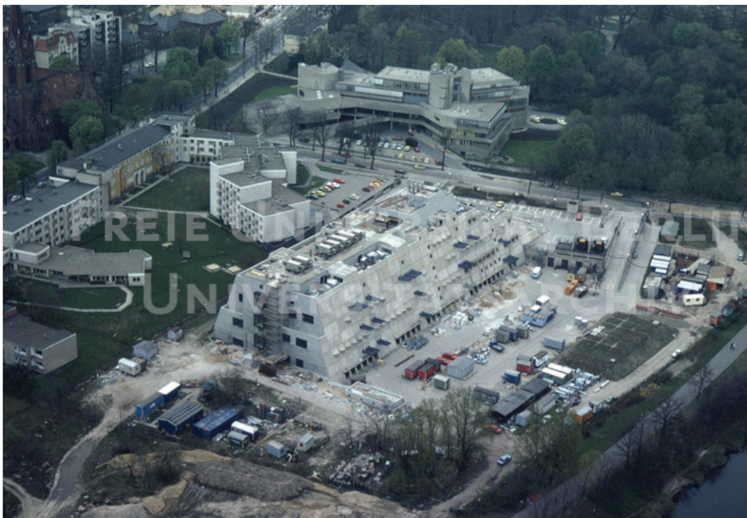
Baustelle, im Hintergrund das Institut für Hygiene und Mikrobiologie, Mai 1980 Quelle: Universitätsarchiv der FU, RFDia/045-07, Foto: Reinhard Friedrich
