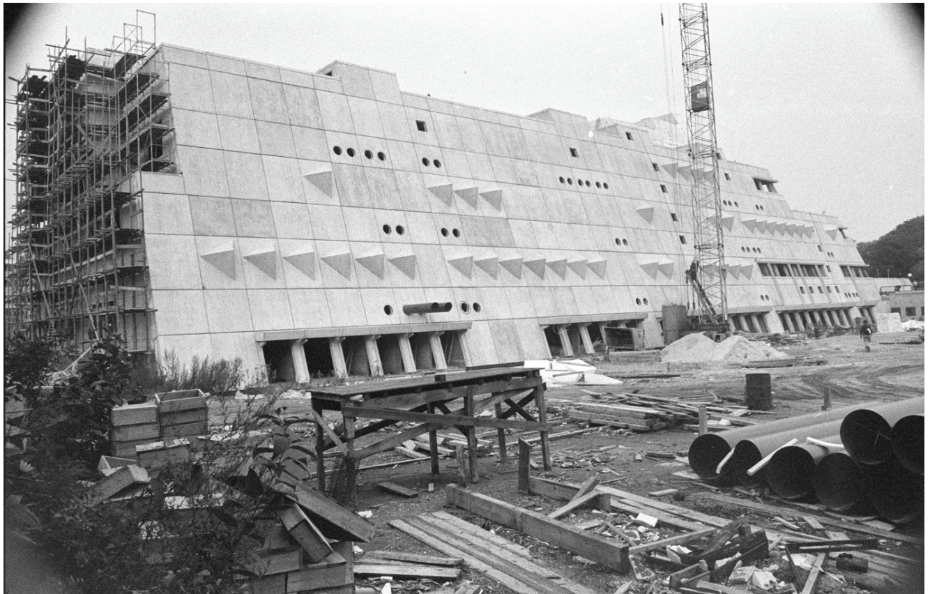
Rohbau, Ostfassade, zwei eingebaute Luftansaugrohre, Südfassade mit Gerüst zur Anbringung der Lattung und der Asbestzementschindeln, 17.10.1975
